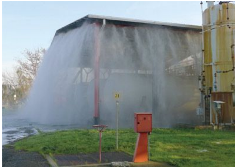
Abbildung 5: Fest installierter Wasservorhang
